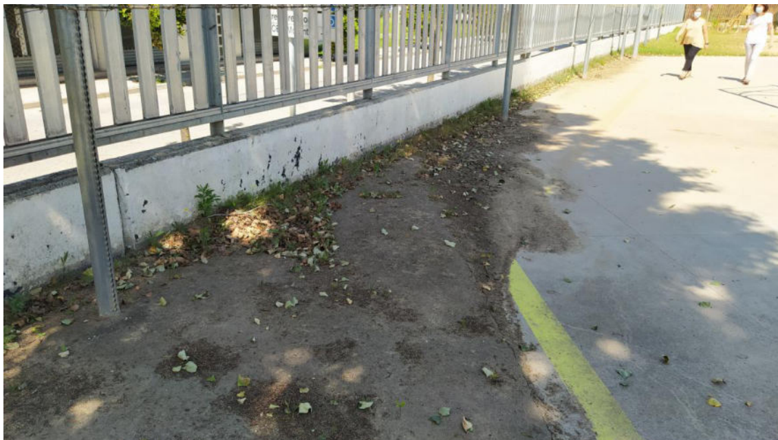
Zona inundable al costat de la tanca:
