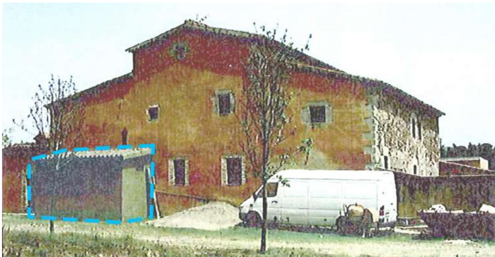
ANNEX ON ES TROVA LA CENTRAL DE DEPURACIÓ EXISTENT
