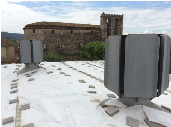
1. Peces de ventilació
