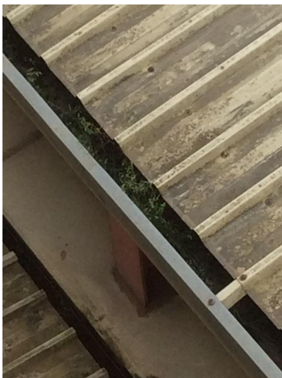
7. Manca de manteniment
