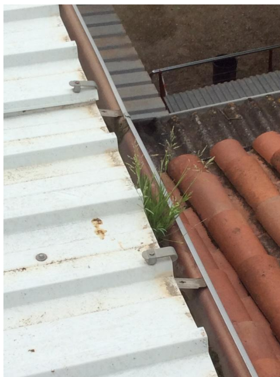
8. Manca de manteniment
